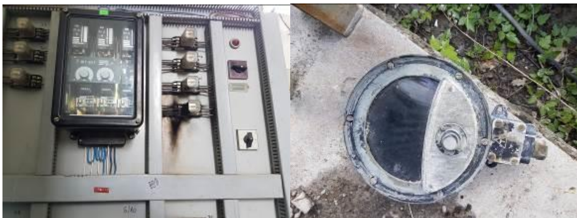
SLIKA 3. OŠTEĆENJA NA KONTAKTNOM TERMOMETRU I SEKUNDARNIM KOLIMA RELEJNE ZAŠTITE.
